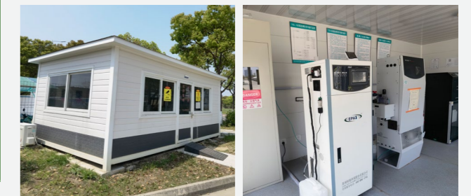
恒瑞医药污水排放口自动监控站房及自动监控设施
